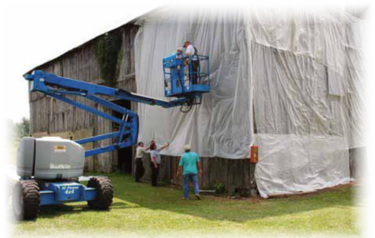
Empleados de Cogentrix Energy, Inc., envuelven en plástico un viejo establo en el Refugio Nacional de Vida Silvestre de las Praderas de Supawna (NJ) para atrapar a los murciélagos antes de iniciar el trabajo de reparación.
